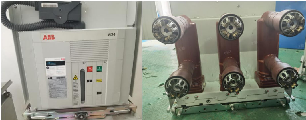
图5 10kV 真空断路器
